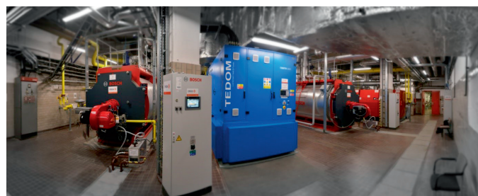
Obr. 4 Kotelna KCP – nová realizace
