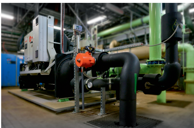
Obr. 8 KCP – strojovna chlazení – nová realizace
