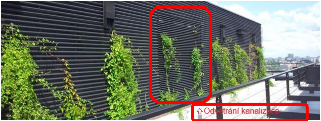
Obr. 6.1 Nevhodné okolí nasávání pro vzduchotechniku
