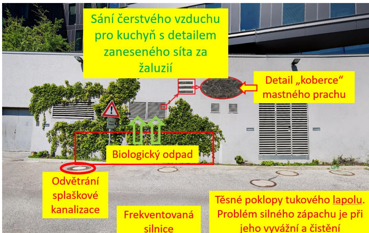
Obr. 2 Nasávání u břechťanu, odvětrání splaškové kanalizace, frekventované silnice
